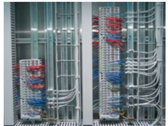
Bild 4 Smarte Installation der Raumautomation: Raumbox mit Ethernet-Controller, Ein-/Ausgabeklemmen, Leistungsrelais, Steckanschlüssen sowie Flachkabel ecobus für Energie und DALI-Kommunikation.
