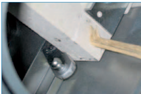
Bild 4: Die Blockierung des Antriebs durch einen Holzkeil löst nur mit kommunikativen Antrieben eine Fehlermeldung aus.
